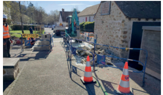
Modification du transformateur ENEDIS, promenade Victor Hugo
